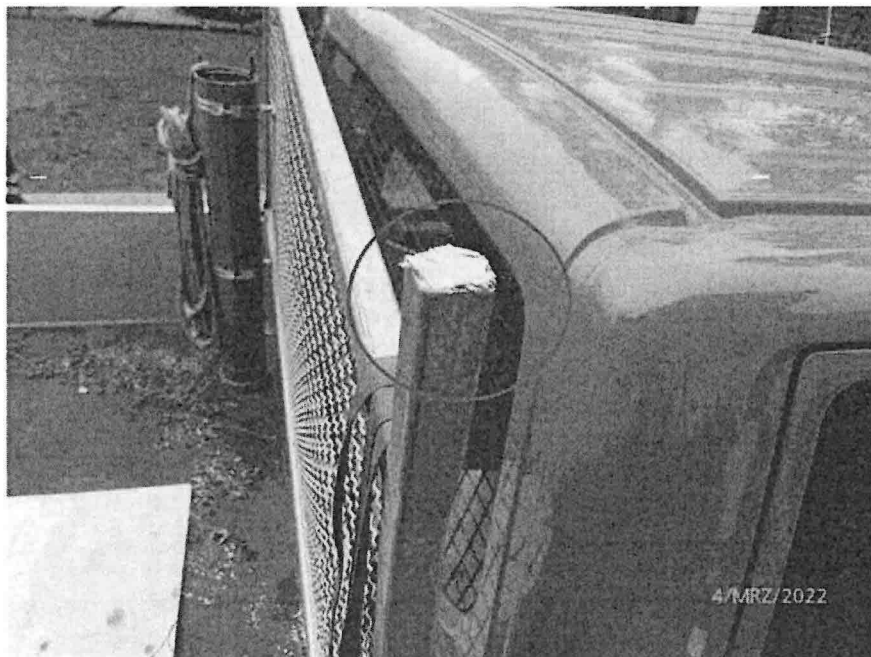
Aufschlagspuren Schutzgitter rechts
